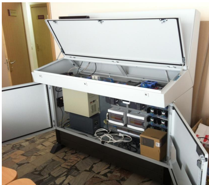
Рисунок 3.80 - Напольный пульт, в котором смонтировано оборудование программно-аппаратного комплекса управления СТСТ стенда «ЭУСТ»
